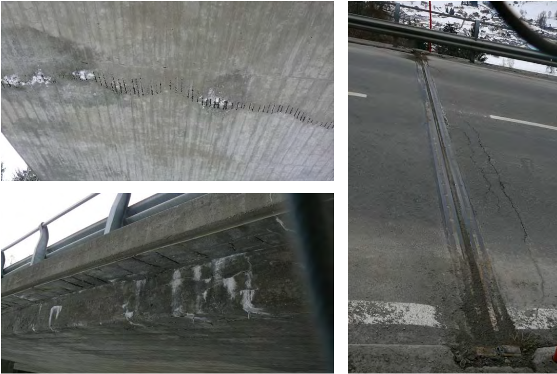
Fig. 2 : Dégradations de l'ouvrage. En haut à gauche, armatures tendues (mi-travée) à l'intrados du tablier, en bas à gauche dégradation bordure, à droite joint de chaussée
