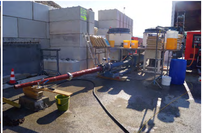
Fig. 18 : Pompe à béton
