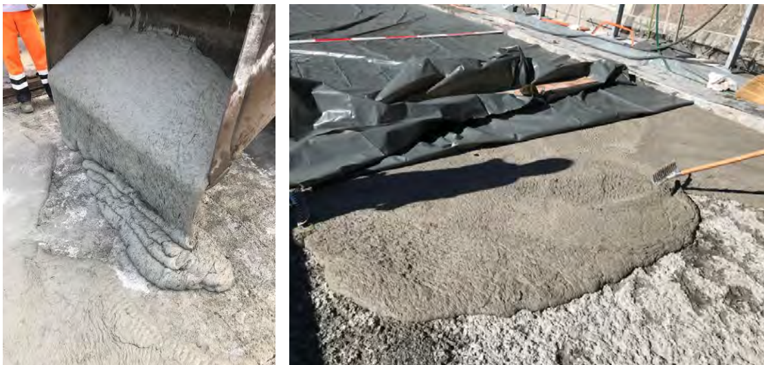
Fig. 9 : Préparation du tablier et mise en place du CFUP sur le tablier
