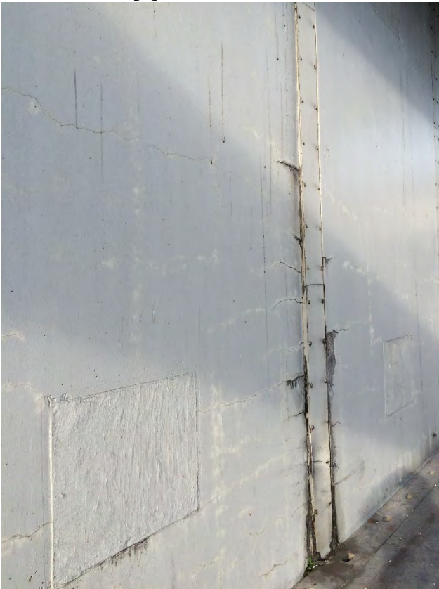
Fig. 5 : Fissuration de la paroi
