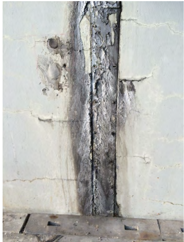
Fig. 6 : État d'un joint entre éléments
