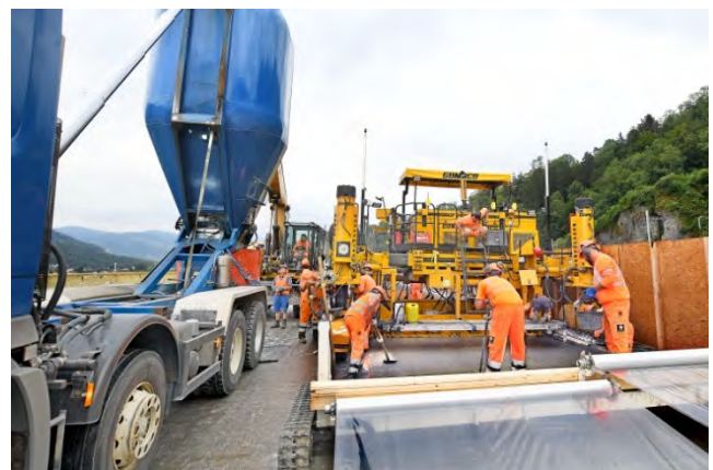
Abbildung 15: Zwischentransport mit Silowagen
