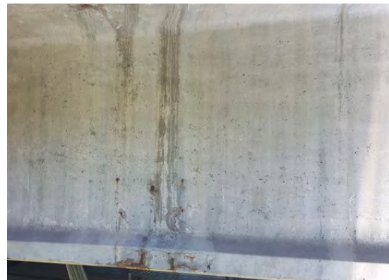
Abbildung 4: Fliessspur am Längsträgersteg
