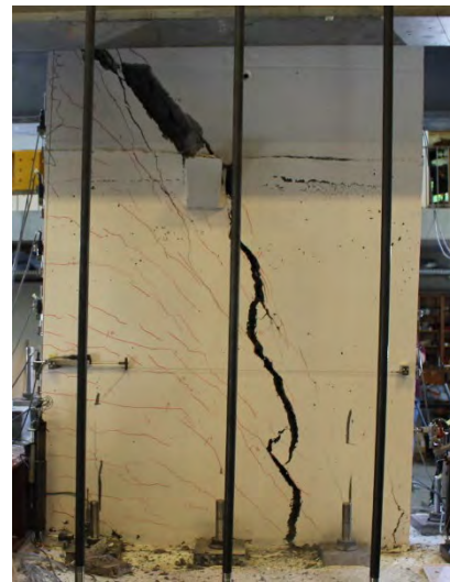
Fig. 15 : Rupture du voile 4
