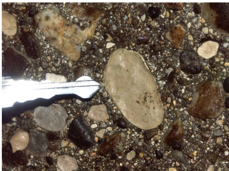
Fig. 10 Erosion de la surface d'un béton usuel suite à une attaque acide
