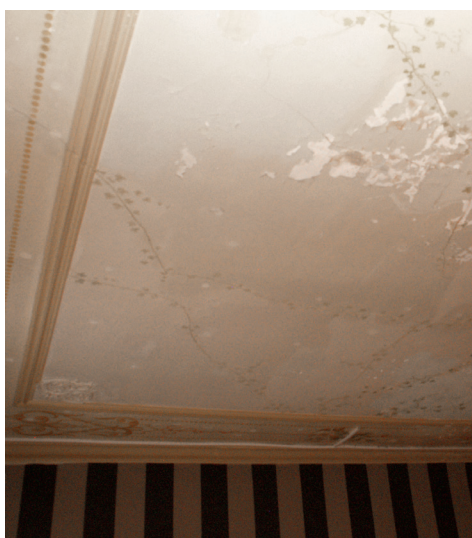
Fig. 20 Le plafond du salon 1900, typique de la Belle Epoque classique, date de 1889. Il représente la nature avec des fleurs. Du lierre a été peint sur les fissures. Aujourd'hui, la conservation du plafond est menacée. Il se dégrade rapidement et nécessite une restauration. « Il faut bien sûr le sauver; mais cela demandera du temps et de l'argent. Il faut avancer à petits pas et procéder par étapes. » 19 © EIA-FR
