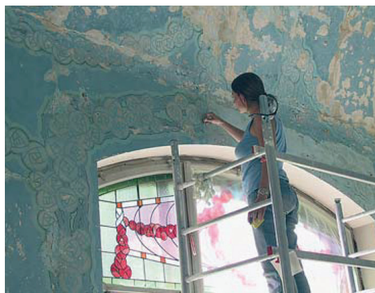
Fig. 65 Restauration du plafond de la salle à manger © Monuments historiques des Grisons
