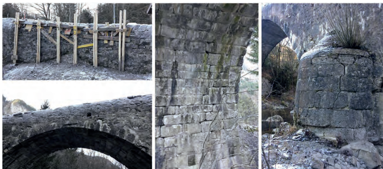
Fig. 2 : Etayage réalisé en urgence pour soutenir la maçonnerie en pierre ; détail de la clef de voûte avant travaux (le gueulard d'évacuation des eaux historique est reconnaissable) ; intrados de la voûte montrant des joints défectueux ; végétation sur le bec de la pile centrale
