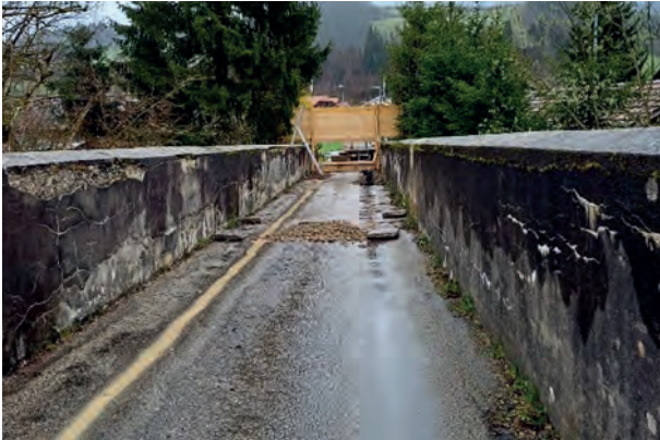
Abb. 5: Beschädigter Verputz und Fahrbahn
