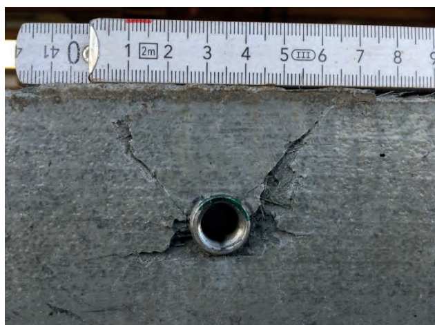
Abb. 21: Rissbild im UHFB bei Muffe M12 mit Gewindestab nach Versagen
