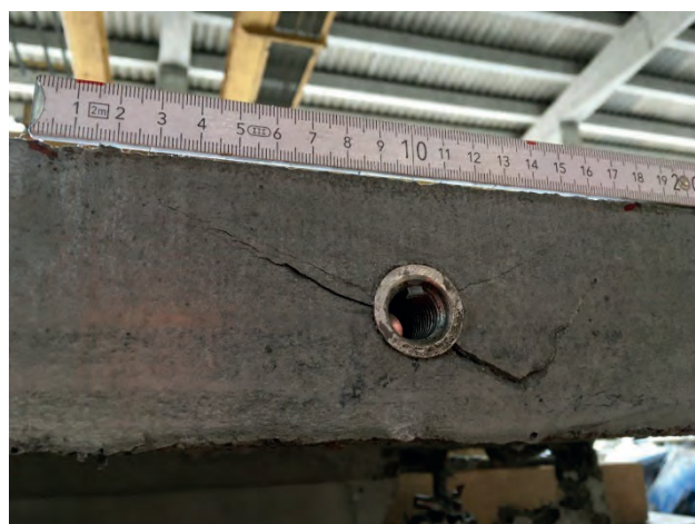
Abb. 22: Rissbild im UHFB bei Muffe M14 mit Betonstahl nach Versagen
