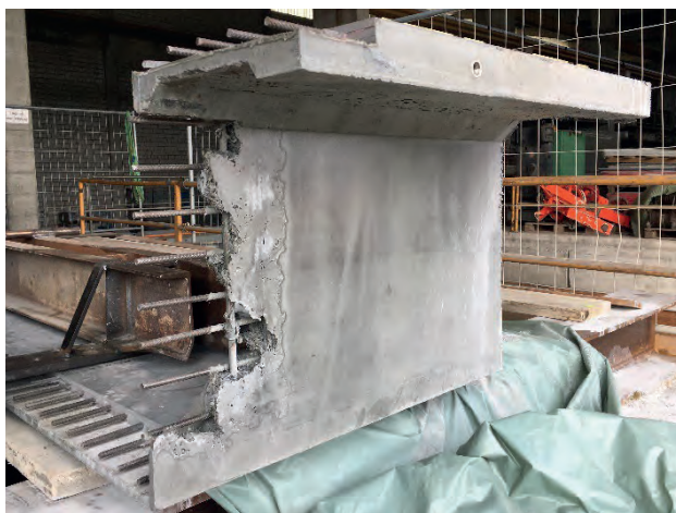
Abb. 9: Randbord Musterelement mit Fehlstellen infolge Entmischungen/Verstopfungen
