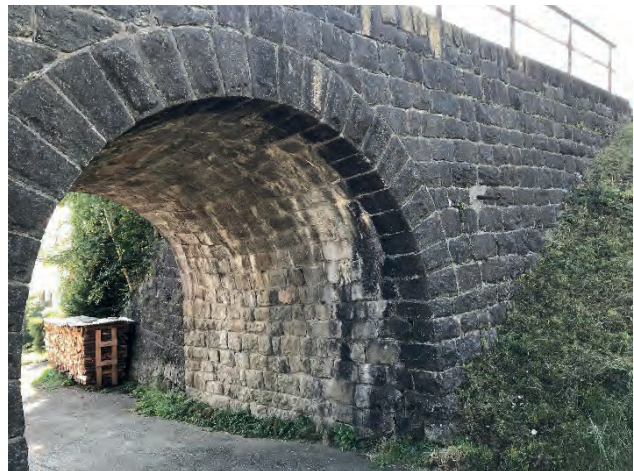
Abb. 1: Wegunterführung Rainhof mit Feuchtstellen beim Gewölbe (Foto B&H 2018)
