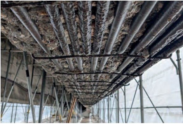
Abb. 16: Der freigelegte Untergurt
