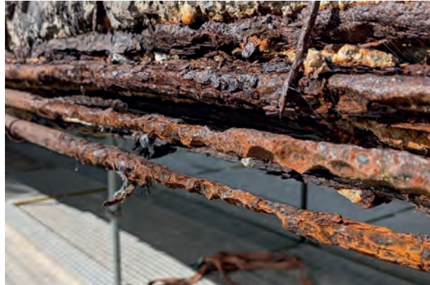
Abb. 6: Korrodierte Bewehrung des Untergurts
