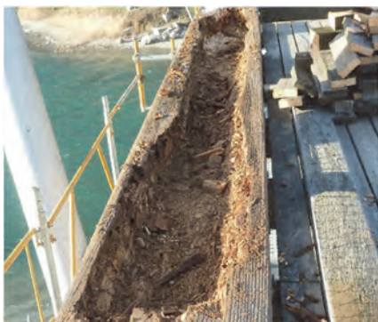
Fig. 2 : Illustration de l'état de la membrure supérieure. Photo du SDM
