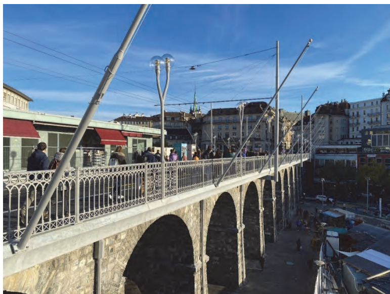
Fig. 10 Vue en enfilade du garde-corps et de la bordure en CFUP (photo INGPHI, 2023)
