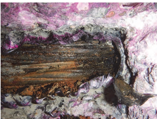
Fig. 6 : Vue des torons corrodés à l'intérieur d'une gaine de précontrainte ouverte dans le cadre des investigations
