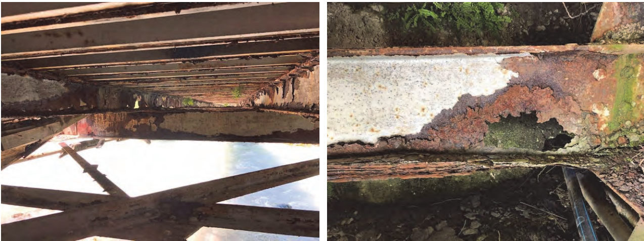
Abb. 3: a) Untersicht der Brücke, b) Querschnittsverlust beim Endquerträger
