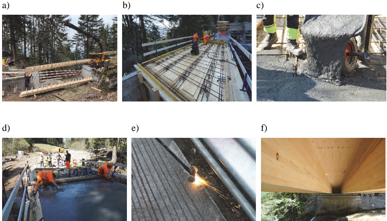
Abb. 5: Fruttlibrücke: a) Montage der Holzträger, b) Verlegen der Betonstahlbewehrung, c) Einbau des UHFB, d) Glätten der UHFB Plattenoberfläche, e) Abflämmen der vorstehenden Fasern, f) Untersicht der Brücke
