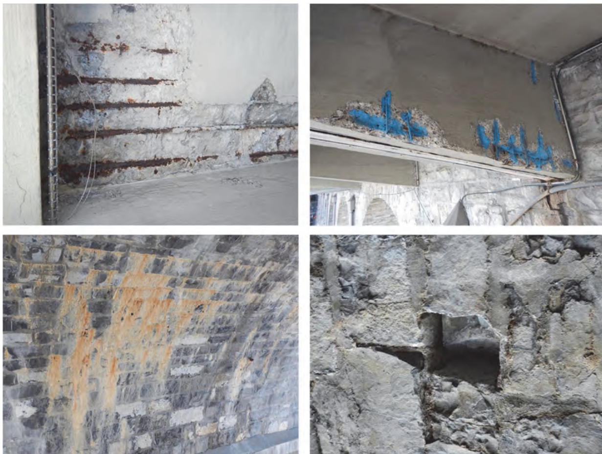
Fig. 4 Dégâts types observés sur les encorbellements en béton (haut) et les maçonneries (bas) (photos INGPHI 2020)
