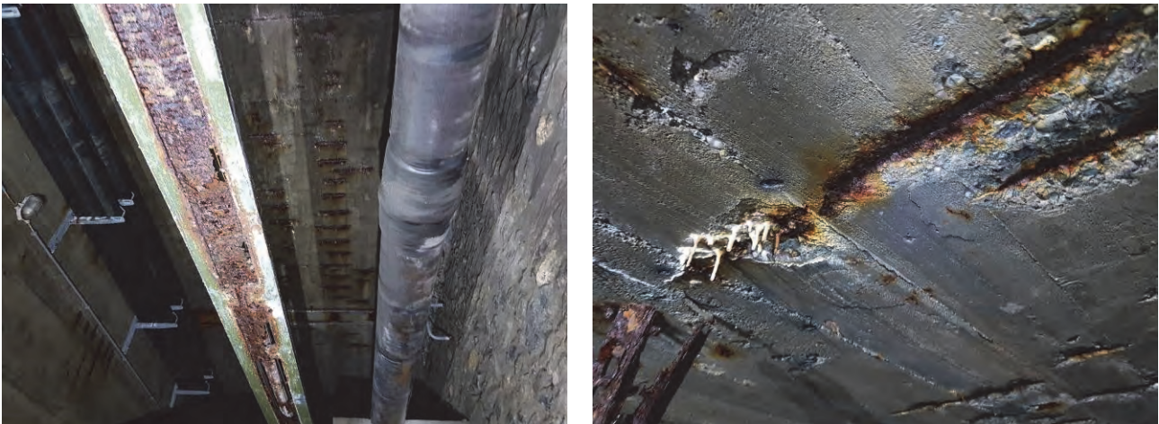
Fig. 5 : Etat de la face inférieure du tablier
