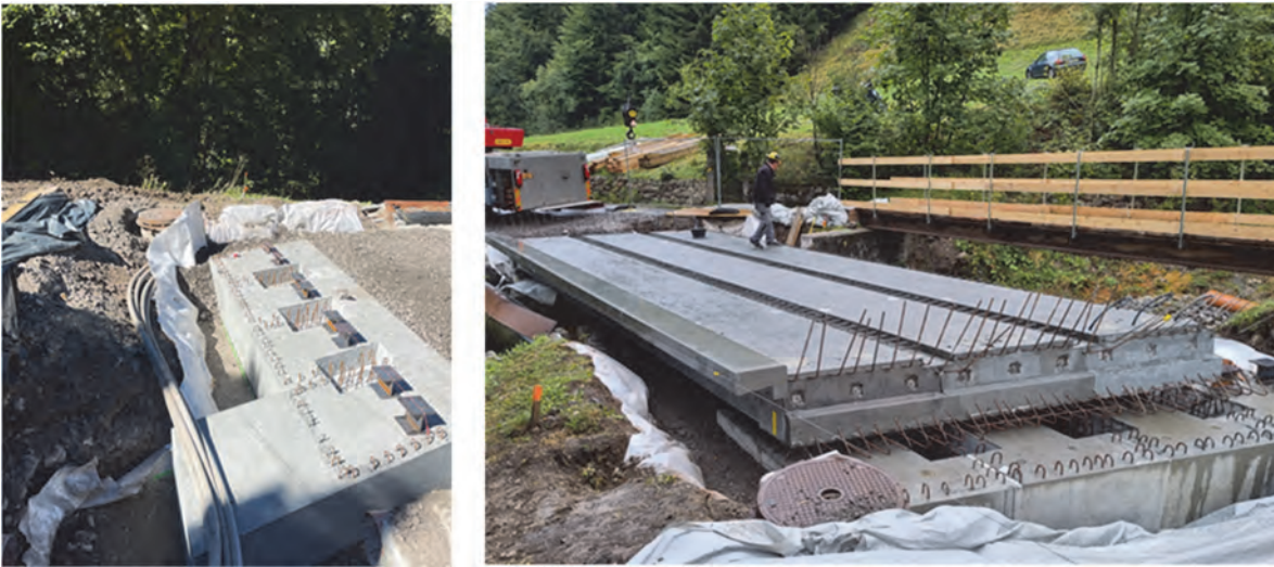
Fig. 6 : À gauche : fondations en béton armé avec élément de bord amont plus long, à droite : éléments du tablier avec armatures en attente
