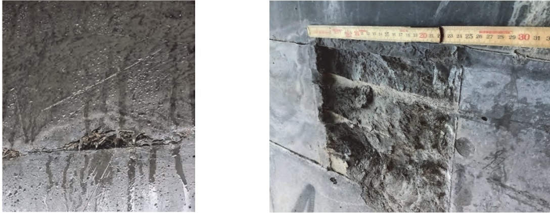
Fig. 5 : Exemples de défauts d'exécution: niches des fibres à gauche ; surface après enlèvement de la goulotte de bétonnage à droite
