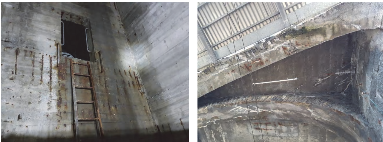
Fig. 6 : Etat des murs et sommiers
