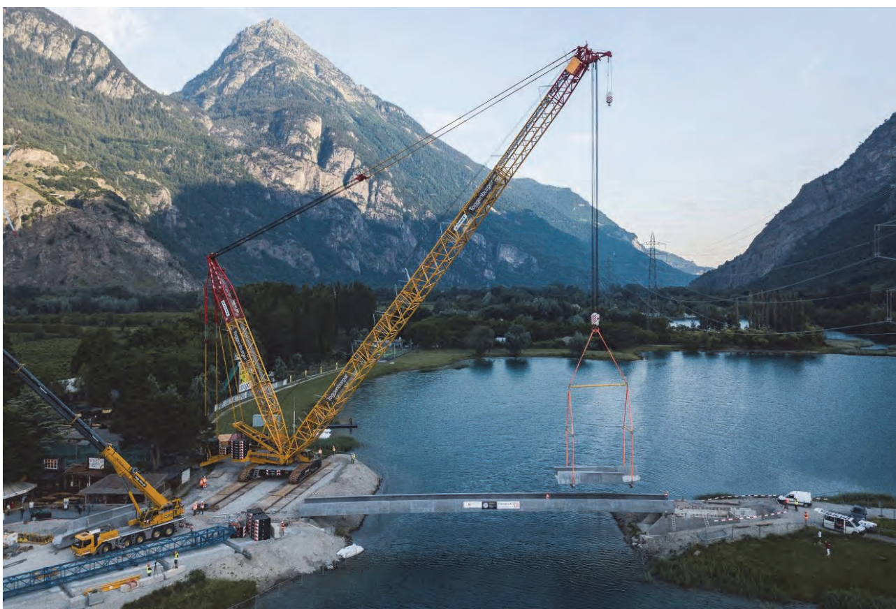
Fig. 11 : Assemblage, mise en tension de la précontrainte, mise en place de la passerelle
