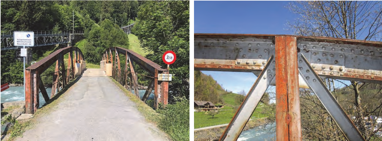
Abb. 2: a) Ausgangszustand des Brückentragwerks mit mittiger Holzkonstruktion zur Überbrückung der durchgebrochenen Belagsflächen, b) Knotendetail des Fachwerkträgers
