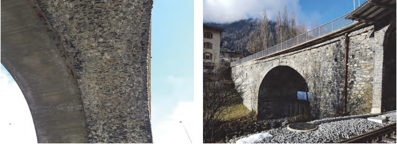
Fig. 4 : Etat de la maçonnerie de pierre
