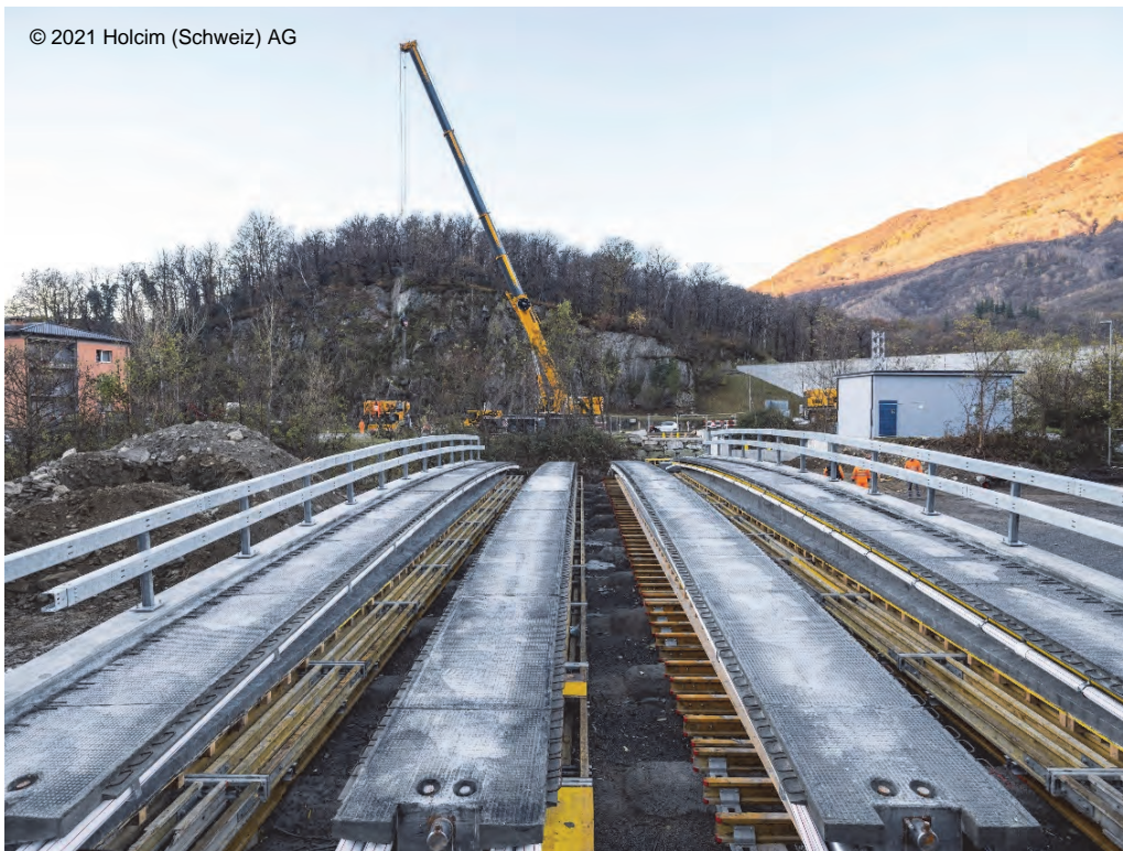
Fig. 13 : Poutres préfabriquées sur le banc de fabrication, avant leur mise en place
