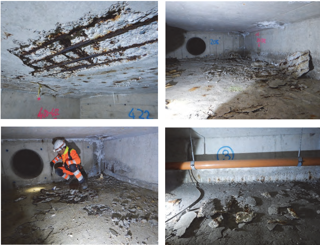
Fig. 5 : Vues des dégâts à l'intérieur du caisson
