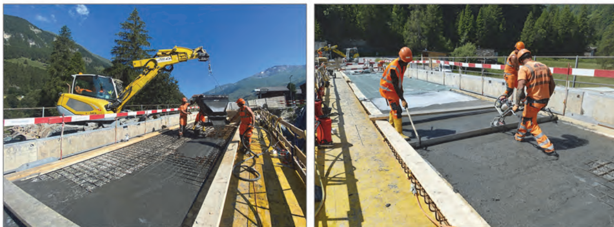
Fig. 11 CFUPage du porte-à-faux et de la couche sur le tablier dans la partie amont de l'ouvrage (Photos du 1 er juillet 2023)
